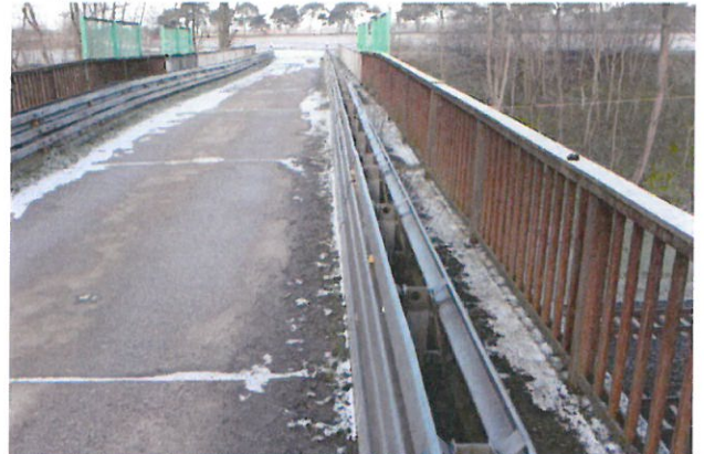
FAHRBAHNEINENGUNG NICHT FACHGERECHT
