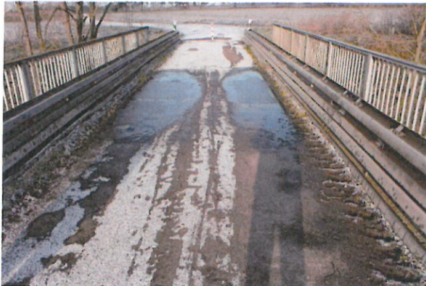
BRÜCKENENTWÄSSERUNG OHNE FUNKTION
