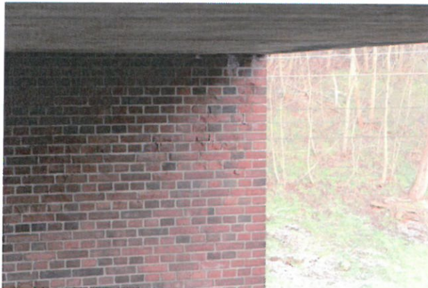
ABPLATZUNG KLINKER PFEILER
